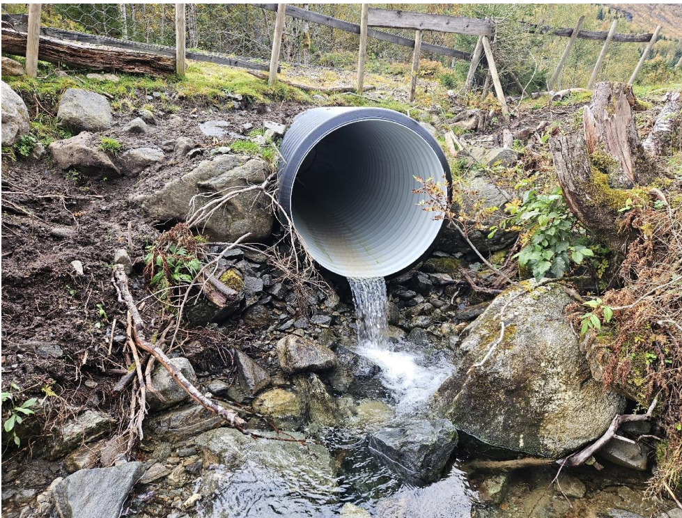
Figur 4-3 Kulvert som utgjør et vandringshinder, men bekken har et annet hinder ca. 100 m nedstrøms dette punktet. Foto: Sweco.
