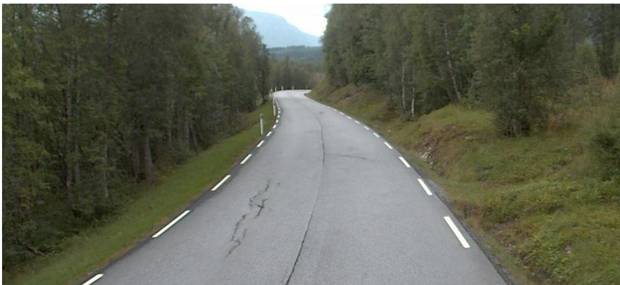
Figur 3-1: Eksempel på oppsprekking av fv.60. Bilde hentet fra Vegbilder [7].
