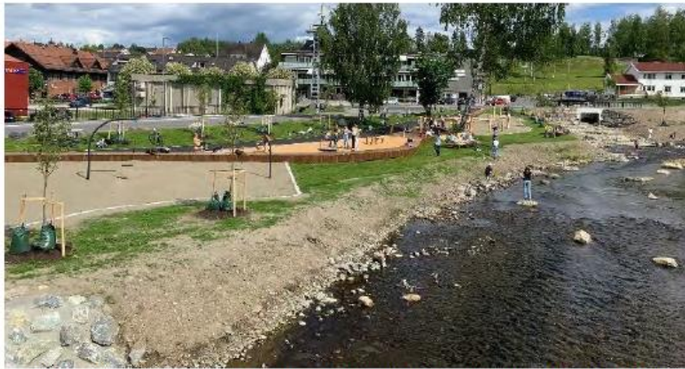
Utvidelse av elva til flomsikring med flomsone brukt som elvepark i Brandbu/Gran kommune (Foto: Gran kommune) 5
